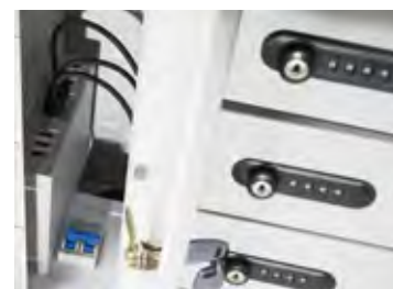
Columna lateral distribuidora de cableado de forma ordenada y segura.
