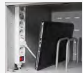
Organización eléctrica con regletas de tomas schucko.
