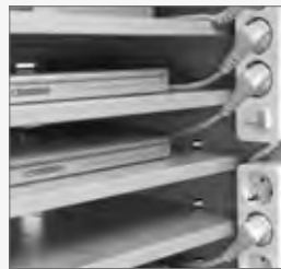
Organización eléctrica con regletas de tomas schucko
